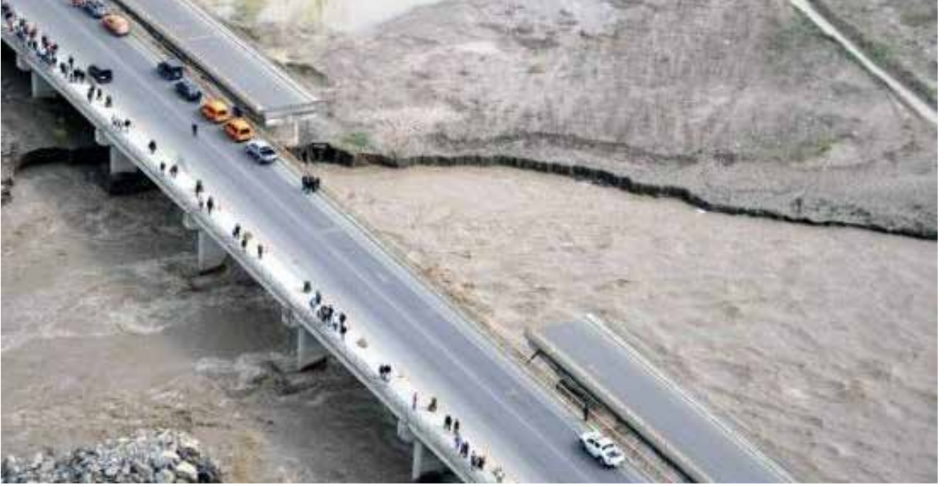
Çaycuma Köprüsü: 6 Nisan'da kısmen yıkılarak 15 cana mal oldu. Kaynak: www.hurriyet.com.tr
