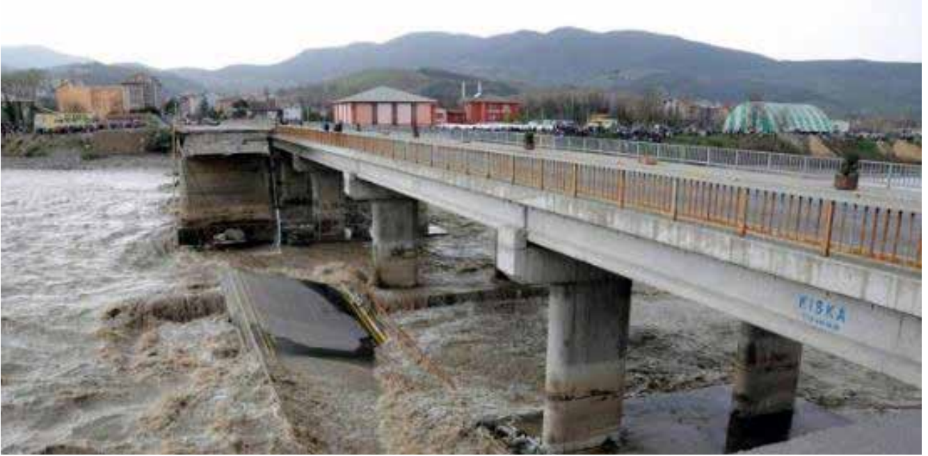
Şekil 2. Çaycuma Köprüsü: 6 Nisan'da kısmen yıkılarak 15 cana mal oldu. Kaynak www.hurriyet.com.tr
